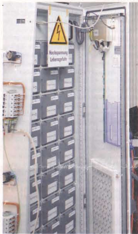
Hochspannung: Batteriespeicher der Firma Varta. Bild: Wraneschitz
